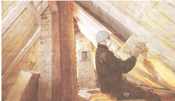
Solierung für die alte Wand: Eine energetische Sanierung kann dazu beitragen, dass Heizkosten gesenkt werden.
